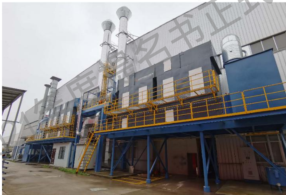
图 5 喷涂废气深度净化系统及装备
